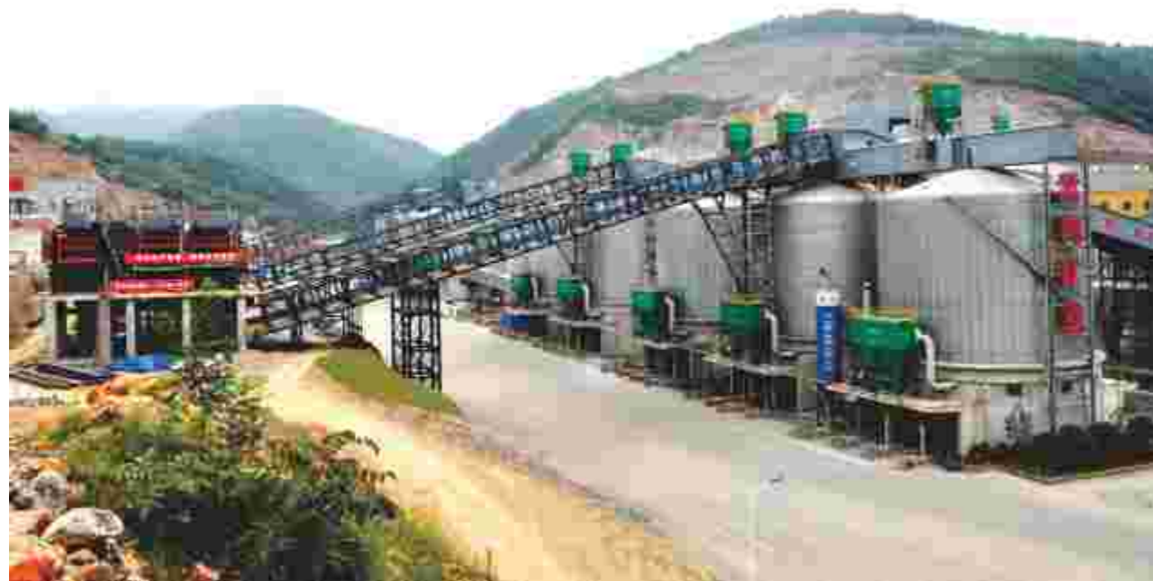
荆门年产2000万吨石灰石破碎生产线（智能矿山）
